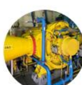
РАЗРАБОТКА И ВНЕДРЕНИЕ СИСТЕМЫ МАГНИТНОГО ПОДВЕСА САУ ЭМП «КВАНТ-Р» НА БАЗЕ РОССИЙСКИХ ПТС на КС Юбилейная КЦ-6 ООО « Газпром трансгаз Ухта»
