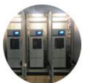
ОПЫТНОЕ ВНЕДРЕНИЕ СИСТЕМЫ АВТОМАТИЧЕСКОГО КОНТРОЛЯ СБРОСОВ ЗАГРЯЗНЯЮЩИХ ВЕЩЕСТВ (САКСЗВ) АО «ЯРОСЛАВЛЬВОДОКАНАЛ»
