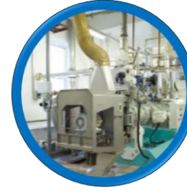
АПК ГК «Мелькомбинат» (г. Рославль) Системы противопожарной безопасности и СВН
