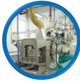
АПК ГК «Мелькомбинат» (г. Ржев) Автоматизация систем управления ТП на элеваторе
